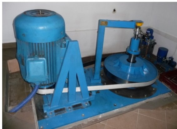
Rys. 1. Przykład małej elektrowni wodnej, gdzie generator asynchroniczny jest napędzany turbiną wodną poprzez przekładnię pasową, generator i turbina pracują ze stałą prędkością obrotową, niezależnie od aktualnych warunków wodnych w rejonie hydroelektrowni
