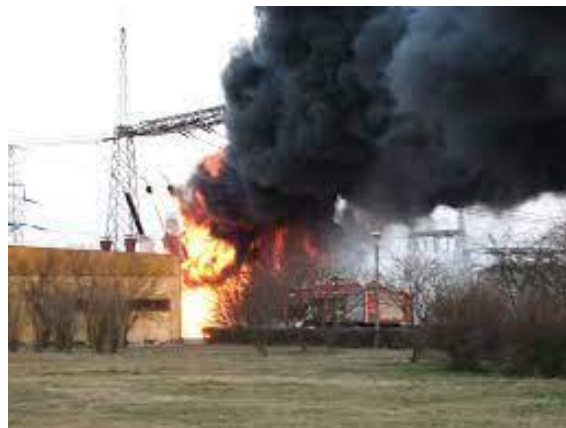
Rys. 2. Płonący transformator 250 MVA, 400 kV/110 kV, [8]
