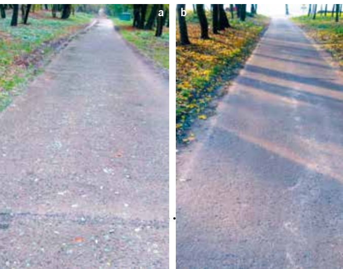
Fot. 4 (a-b). Widok 75-letniej nawierzchni z betonu cementowego na drodze dojazdowej do nieistniejącego obecnie lotniska wojskowego we wsi Sokołówek w powiecie ciechanowskim. Obecnie jest to droga dojazdowa do magazynów oraz przyległych posesji. Zdjęcia wykonał autor w październiku 2015 roku
