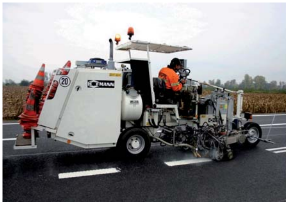
Fot. 12. Maszyny do wykonywania oznakowania grubowarstwowego z masy termoplastycznej
