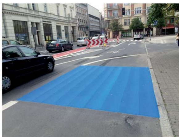
Fot. 17. Nawierzchnia przed aplikacją natryskowej masy chemoutwardzalnej plastirok spray i po aplikacji
