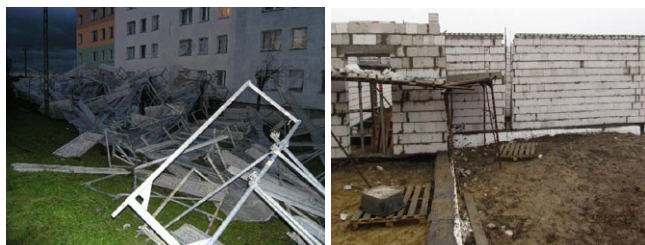
Rys. 7, 8. Zawalenie i deformacje rusztowań wskutek nieprawidłowości w ich zakotwieniu (opracowanie własne)
