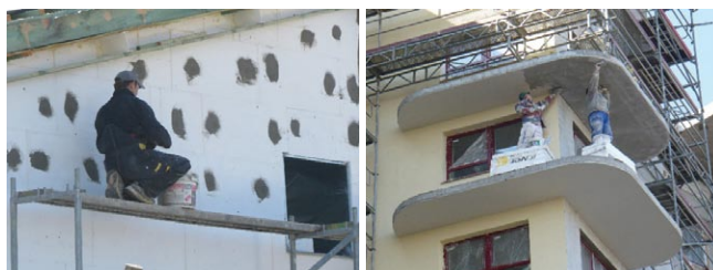
Rys. 3, 4. Ryzykowne zachowania i braki elementów zapewniających bezpieczeństwo pracy (opracowanie własne)
