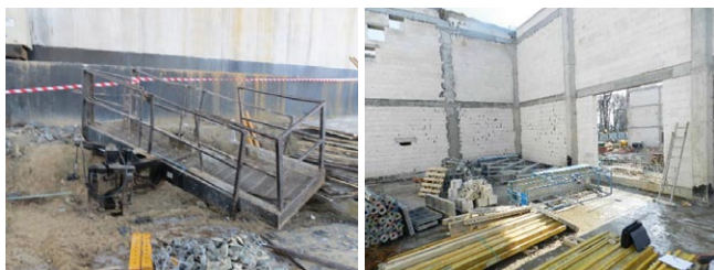
Rys. 15, 16. Wadliwe zabezpieczenia i nieprawidłowy montaż sprzętu do podnoszenia (opracowanie własne)
