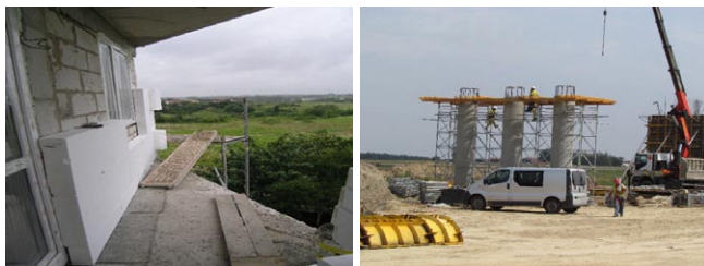
Rys. 11, 12. Prowizoryczne przejścia oraz brak drabinek w rusztowaniach (opracowanie własne)
