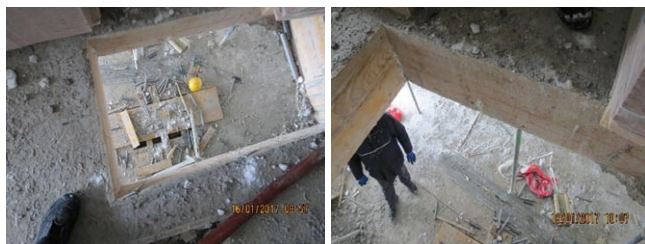
Rys. 9, 10. Nieprawidłowe zabezpieczenie otworu technologicznego stropu (opracowanie własne)
