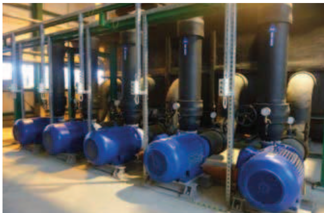
Rys. 1. Fragment stacji sprężarek z silnikami systemu schładzania solanki przy mrożeniu szybu GG-1 w Legnickim Zagłębiu Miedziowym [16]
