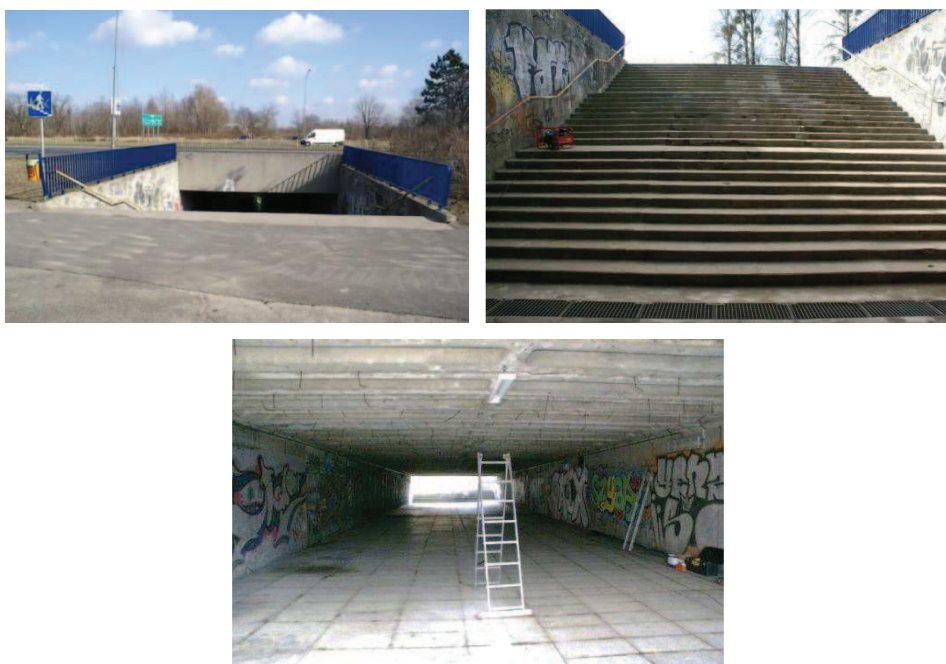
Fot. 1–3. Przejście podziemne – stan przed wykonaniem robót budowlanych
