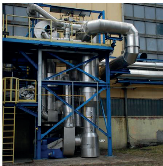
Rys. 7. Zespół zgazowarki fluidalnej Torbed o mocy 5 MW
