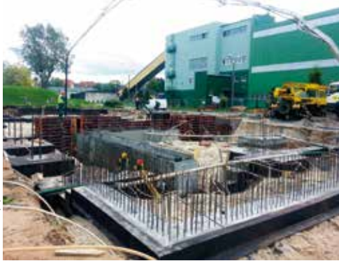
Rys. 2. Nieprawidłowo zbrojone naroże ściany. Budynek elektrociepłowni. Brak uciąglenia prętów zbrojeniowych (zdjęcie z lewej)
