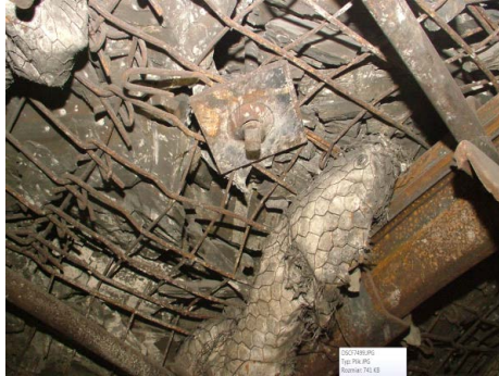
Rys. 5. Słabo dociśnięte podkładki kotwowe poprzez kotew z kutym łbem
