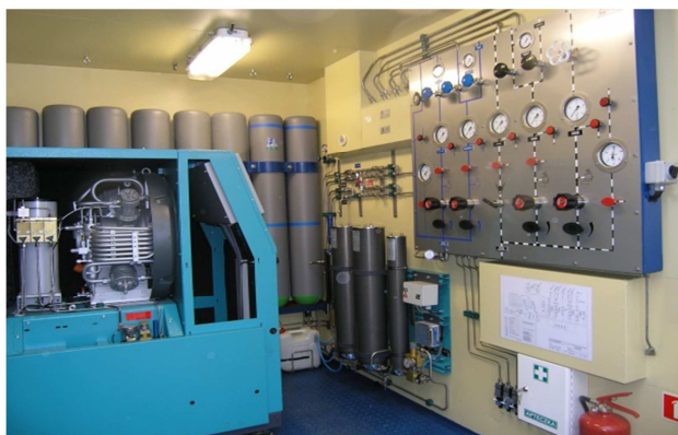
Rys. 20. Widok ogólny wnętrza kontenera Przenośnego Zestawu Zasilania Powietrzem. Źródło: opracowanie własne.
