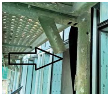
Wycięte usztywnienie węzła ramy
