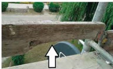
Uszkodzony krawężnik (bortnica)
