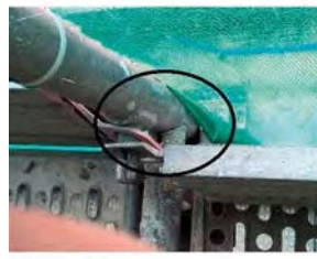
Widok z góry - pęknięcie połączenia dolnej poprzeczki i słupka ramy
