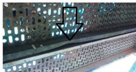
Uszkodzenie pomostu - wygięcie wzmocnienia bocznego
