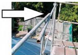
Brak ciągłości poręczy
