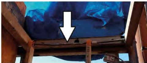
Uszkodzone zamocowanie drabinki - wygięty pręt
