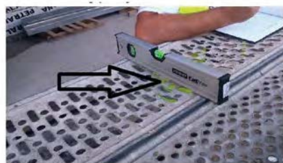
Uszkodzenie pomostu - ugięcie w pionie perforowanej powierzchni pomostu
