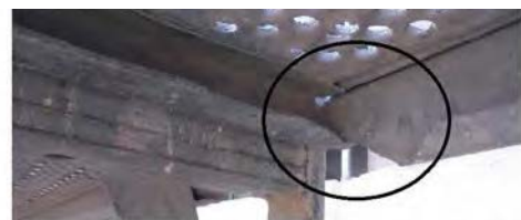
Uszkodzenie pomostu - wygięcie blach poprzecznic
