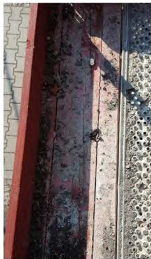
Spękany i jednocześnie zabrudzony pomost drewniany
