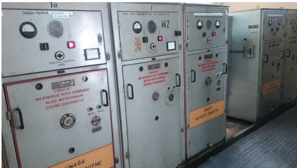
Rys. 2. Pola rozdzielcze typu RSK-6 rozdzielni SN 3 kV „Wilson”
