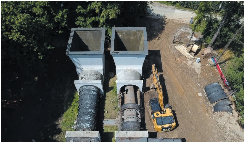
Rys. 1. Wentylatory głównego przewietrzania szybu „Wilson”
