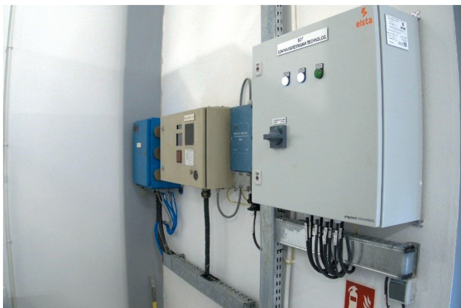
Rys. 7. Aparatura kontrolno-pomiarowa systemu „Venturon”
