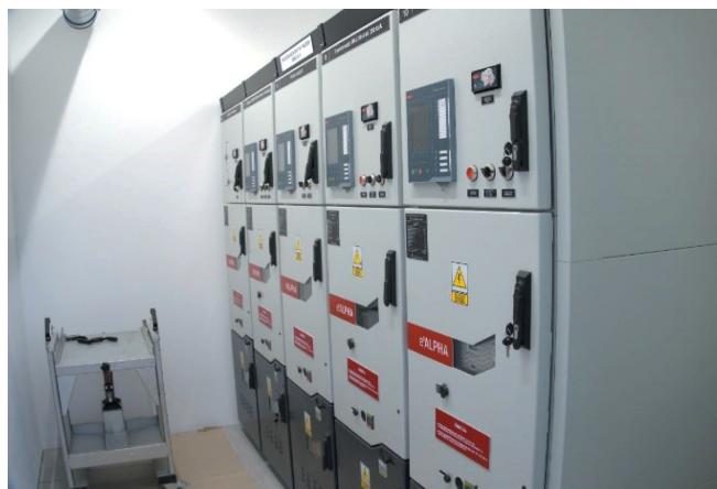
Rys. 5. Celki rozdzielcze typu e 2 ALPHA rozdzielni SN 3 kV „Wilson”
