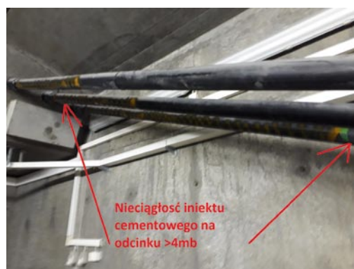
Rys. 12. Zdiagnozowana podczas inspekcji nieciągłość iniektu długości około 4 m
