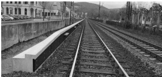
Fot. 8. Niski ekran akustyczny żelbetowy
