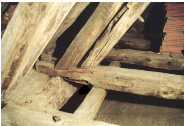
Ryc. 30. Zniszczona belka stropowa w węźle podporowym wiązara pełnego Fig. 30. Destroyed floor beam at the support joint of the main truss
