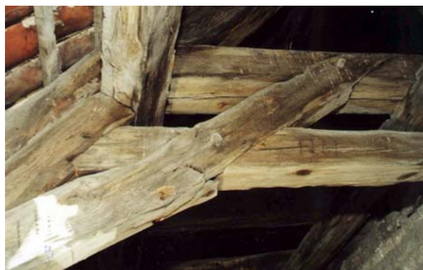
Ryc. 25. Złamany zastrzał w nawie bocznej
