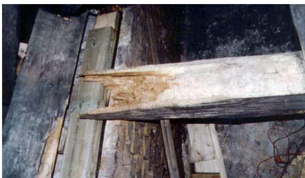
Ryc. 19. Przykład uszkodzenia końcówki belki stropowej przez grzyb domowy Fig. 19. Example of damage to a floor beam tip due to house fungus
