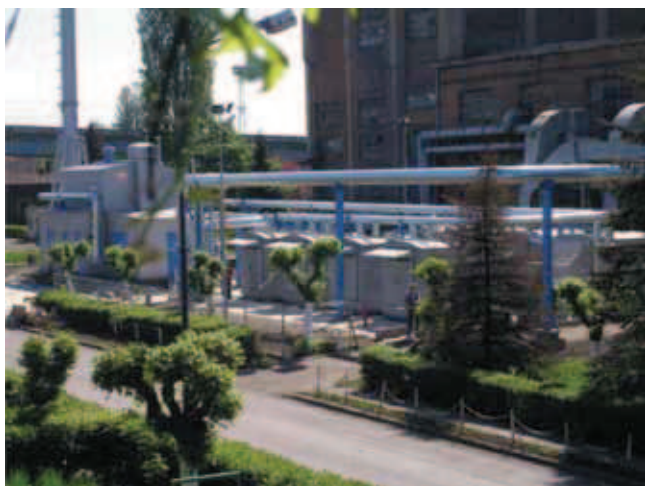
Rys. 11. Kotły gazowe spalające metan z odmetanowania w KWK „Sośnica-Makoszowy”
