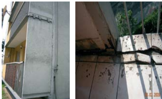
Rys. 4. Widok balkonów (1) oraz uszkodzenia w obszarze mocowania balustrady [źródło: opracowanie własne]
