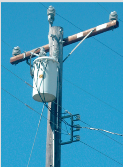
Fot. 1. Sieć rozdzielcza wysokiego napięcia w dzielnicy willowej Danville, nieopodal San Francisco
