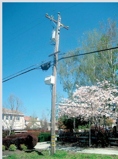
Fot. 2. Sieć rozdzielcza niskiego napięcia w dzielnicy willowej Danville, nieopodal San Francisco
