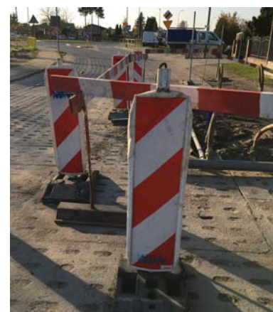
Fot. 9. Ogrodzenie miejsca robót deskami, stwarzającymi sytuację niebezpieczną (fot. Natalia Konkel)
