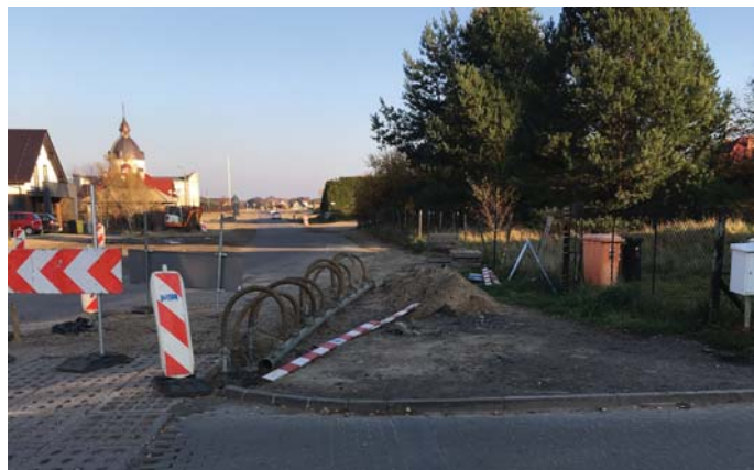
Fot. 12. Niezabezpieczona strefa robót (fot. Natalia Konkel)
