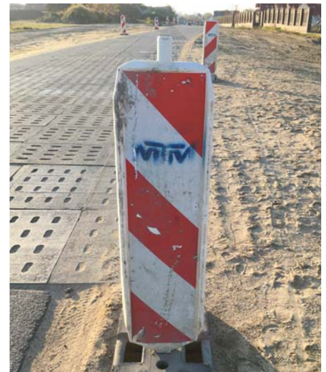
Fot. 17. Zły stan techniczny znaku U-6d (fot. Natalia Konkel)
