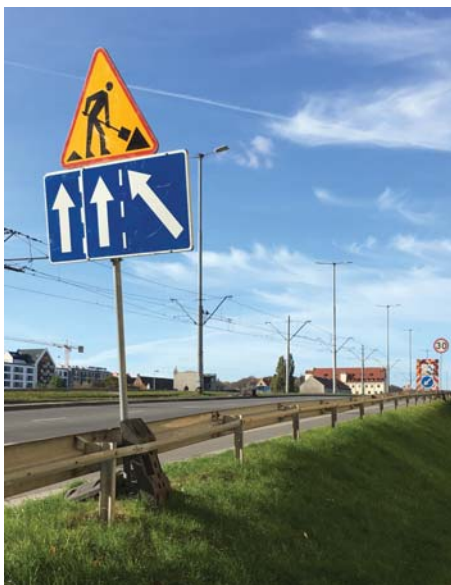
Fot. 2. Znak A-14 „roboty drogowe” oraz F-16 umieszczone przed miejscem występowania robót drogowych (fot. Natalia Konkel)
