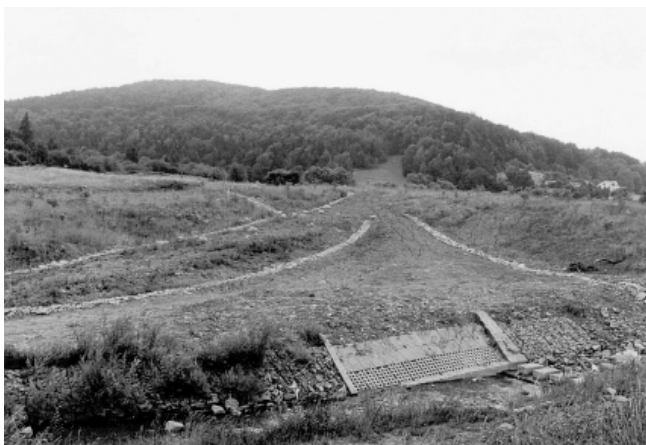
Ryc. 8 Fragment dolnej części osuwiska, z którego usunięto duże ilości gruntu w trakcie prowadzenia prac stabilizujących stok Ryc. 8 A lower part of the landslide after removing part of land mass during stabilizing works
