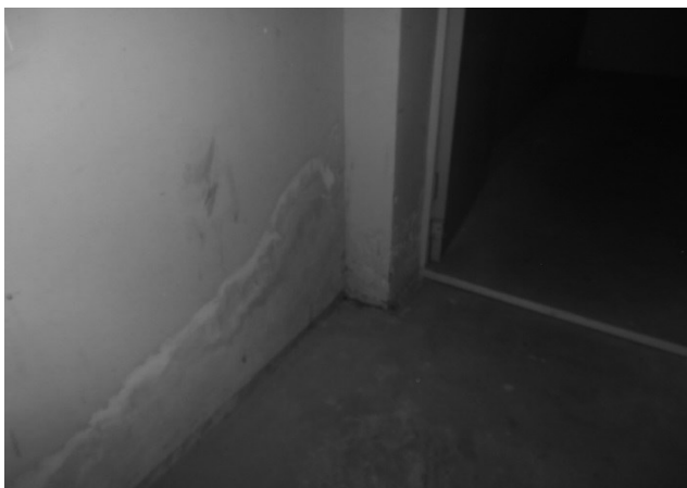
Podciąganie kapilarne wilgoci na ścianach fundamentowych.
