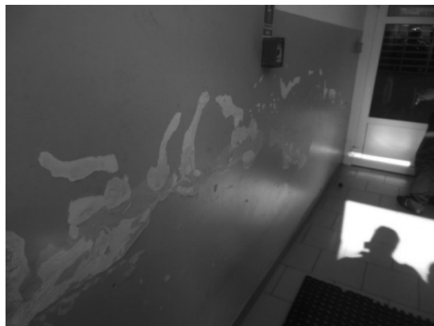
Uszkodzenia tynku na ścianie przy wejściu do piwnicy spowodowane zawilgoceniem.
