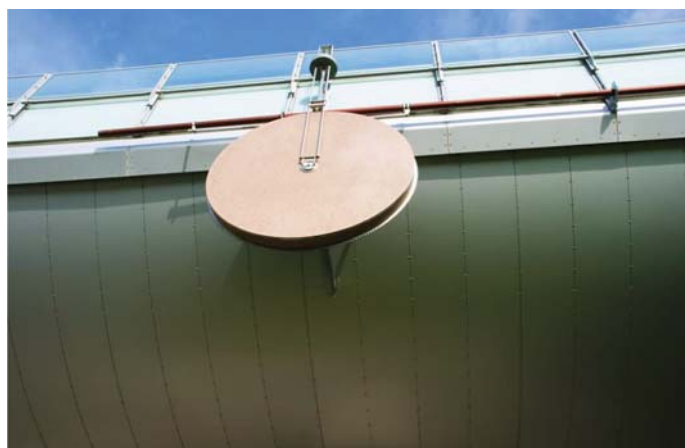
Fot. 17. Instalacja artystyczno-techniczna mostu Drammen służąca rejestracji przemieszczeń termicznych konstrukcji
