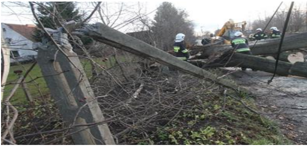
Rys.2. Przykładowe uszkodzenie linii napowietrznej wywołane uszkodzeniem przez gałęzie drzew [1]
