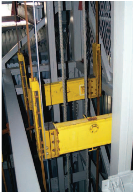
Rys. 3. Ruchome belki odbojowe zainstalowane w wieży szybu
