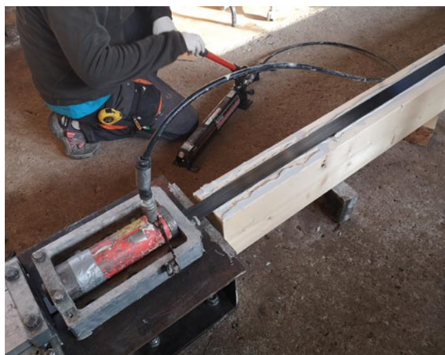
Rys. 14. Nakładanie kleju na bazie żywicy na przygotowaną powierzchnię belki, napinanie taśmy za pomocą siłownika hydraulicznego
