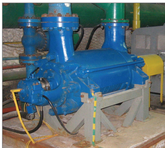
Rys. 5. Widok wielostopniowej pompy odśrodkowej w głównej stacji odwadniania kopalni
