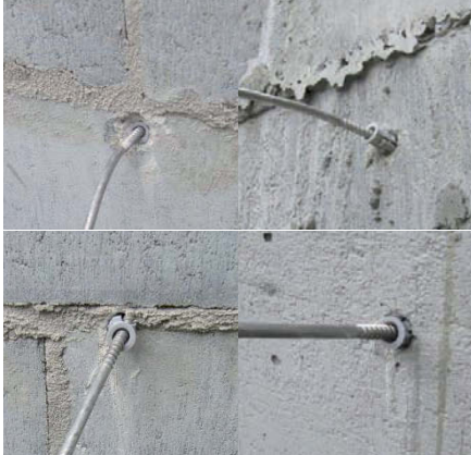
Rys. 10. Niedokręcone kotwy na ścianie rozebranej po awarii [3]
