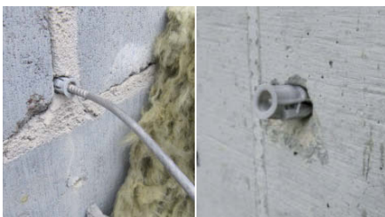
Rys. 13. Wady osadzenia kotków w murze; kotek w spoinie pionowej, za płytkie osadzenie kotka [3]
