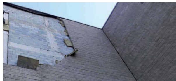
Rys. 9. Widok elewacji po awarii ściany szczelinowej [3]
