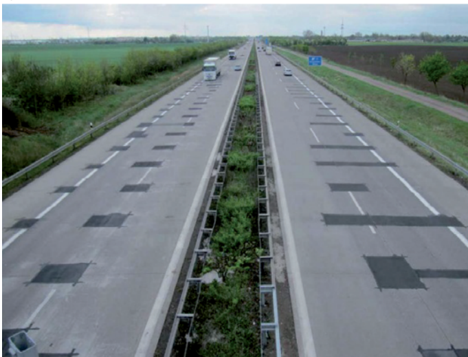
Fot. 4. Wzrost zakresu uszkodzeń powstałych wskutek reakcji AKR na autostradzie A14 koło miejscowości Halle/Saale: a) widok nawierzchni w początkowej fazie obserwacji; b) widok nawierzchni po okresie 10 miesięcy [1]
