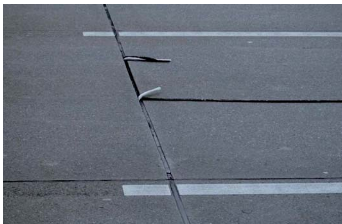
Fot. 1. Zalwa wyciągnięta ze szczeliny po jednorocznym okresie eksploatacji [1]
