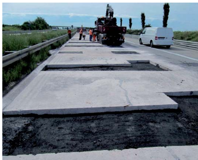
Fot. 5. Roboty naprawcze wskutek uszkodzeń spowodowanych wystąpieniem reakcji AKR; istnieje niebezpieczeństwo powstania uszkodzeń z powodu oddziaływania wysokiej temperatury [1]
