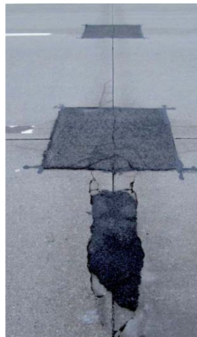
Fot. 2. Przykładowe uszkodzenia powstałe wskutek reakcji alkaliów z kwasem krzemowym (AKR); widoczny jest postęp uszkodzeń w obszarze szczelin [1]
