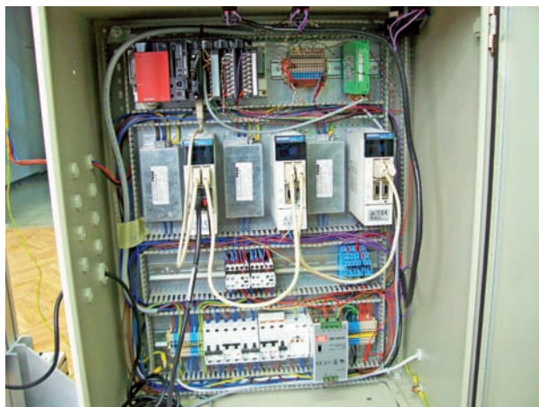
Rys. 5. Wnętrze szafy sterowniczej robota Renus-2
