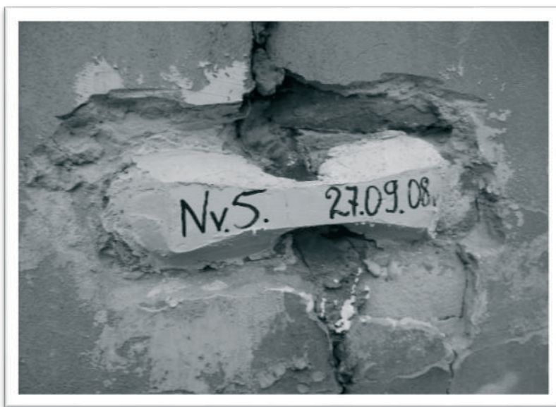
Rys. 1. Założona plomba gipsowa po kontroli okresowej przeprowadzonej przez zarządcę obiektu
