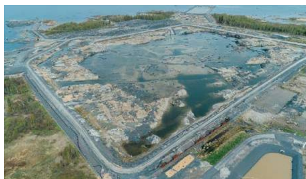
Fot. 2. Prace makroniwelacyjne pod główne budynki: reaktorownię i maszynownię, stan na dzień 28.05.2019 (fot. Fennovoima, CC BY-NC-ND 2.0). Nie zainstalowano jeszcze systemu drenażowego, czego efektem jest widoczny na zdjęciu wysoki poziom lustra wody.
