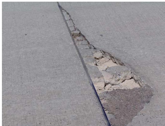
Fot. 15. Uszkodzenie związane z błędami technologicznymi – niewłaściwe ułożenie dybli. Autostrada A4 [8]
