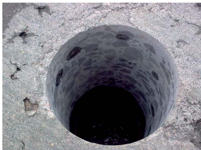
Fot. 2. Uszkodzenie powierzchniowe – wykwity i lejki wokół wykonanego odwiertu. Droga krajowa nr 18 [4]
