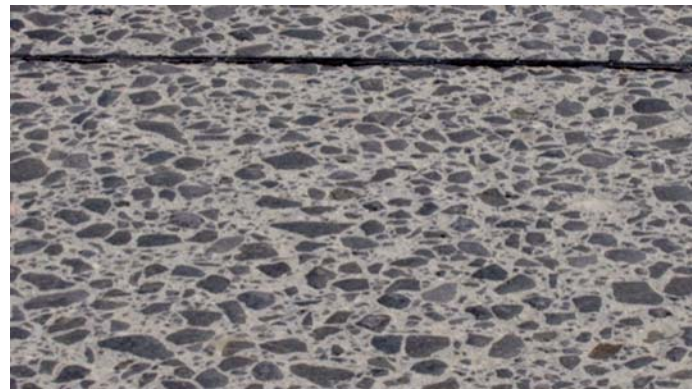
Fot. 6. Uszkodzenie powierzchniowe – wytarcie górnej warstwy nawierzchni i ekspozycja ziaren kruszywa. Droga krajowa nr 18 [4]
