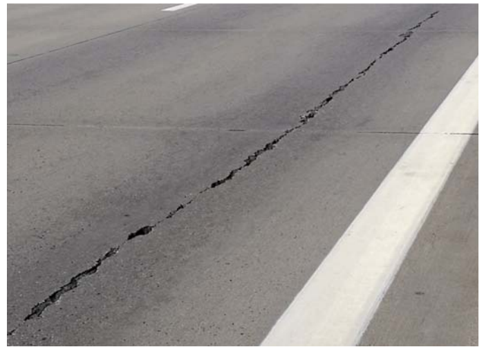
Fot. 10. Uszkodzenie strukturalne – spękania podłużne. Autostrada A18 [8]
