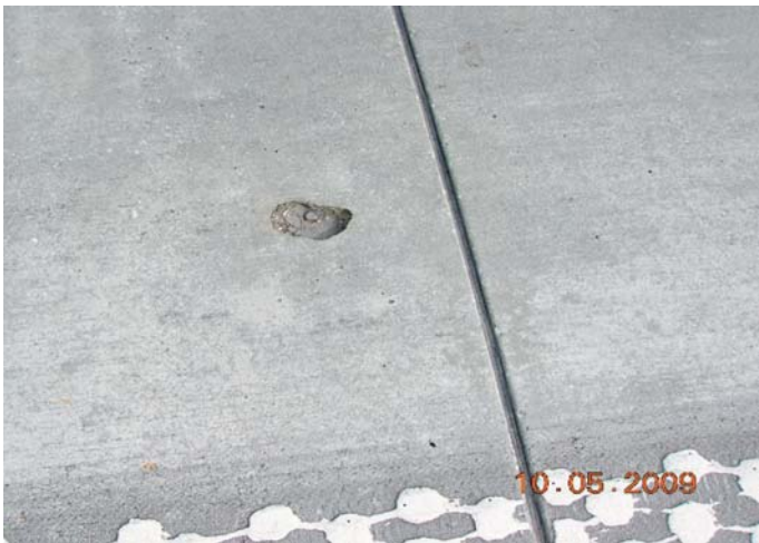
Fot. 3. Uszkodzenie powierzchniowe – ubytki związane z wykruszeniem górnej powierzchni. Autostrada A4 [4]
