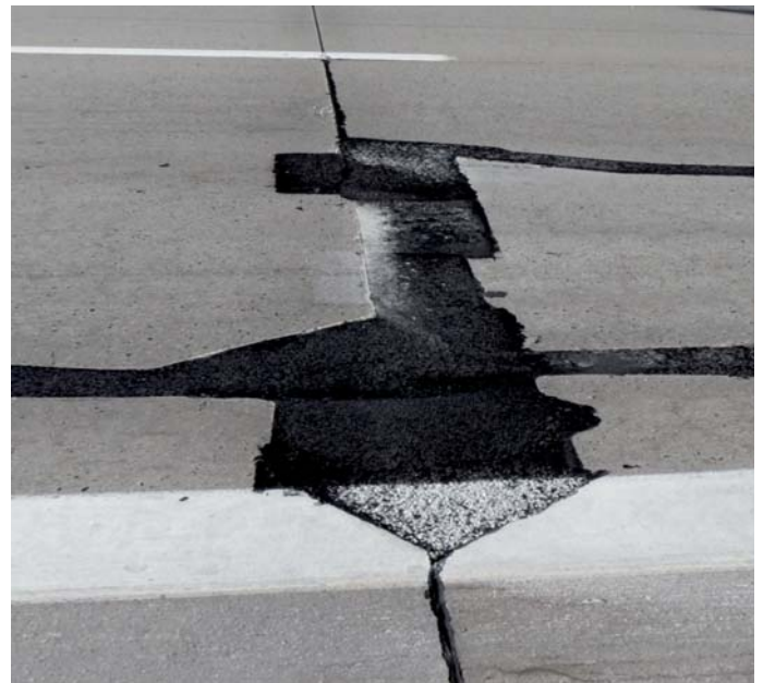
Fot. 11. Uszkodzenie strukturalne – uszkodzenie szczelin, spękania podłużne, zapadnięcie płyty. Autostrada A4 [8]
