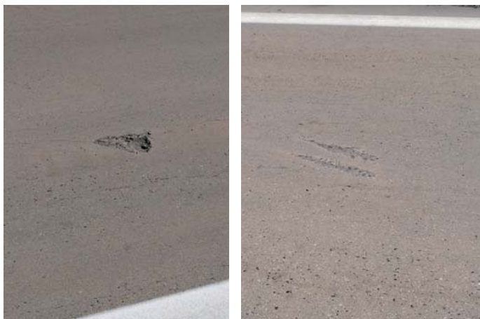
Fot. 19–20. Uszkodzenie eksploatacyjne – uszkodzenia mechaniczne po upadku przewożonego ładunku. Autostrada A18 [3]
