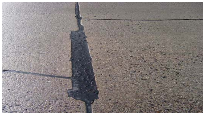
Fot. 23. Efekt naprawy przy pomocy preparatów systemowych na bazie substancji ropopochodnych. Autostrada A18 [8]
