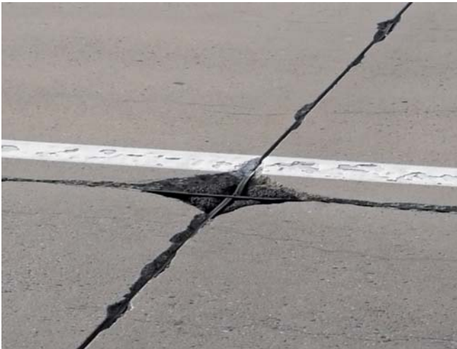
Fot. 8. Uszkodzenie strukturalne – wykruszenia naroży, wykruszenia krawędzi, deformacja szczelin. Autostrada A18 [3]
