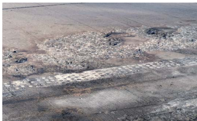
Fot. 18. Uszkodzenie eksploatacyjne – wżery w nawierzchni w miejscu, w którym spłonął samochód ciężarowy. Autostrada A4 [8]
