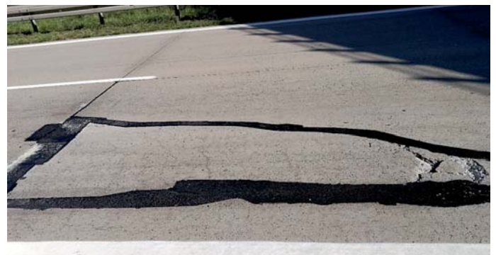
Fot. 12. Uszkodzenie strukturalne – zapadnięcie płyty. Autostrada A4 [8]
