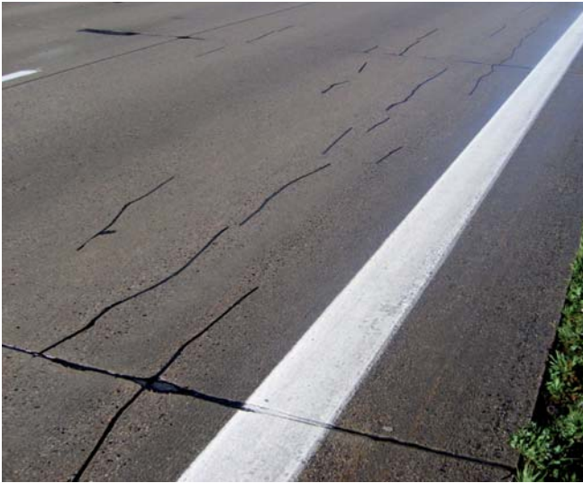
Fot. 7. Uszkodzenie strukturalne – spękania podłużne, uszkodzenie krawędzi, deformacja szczelin. Autostrada A18 [3]
