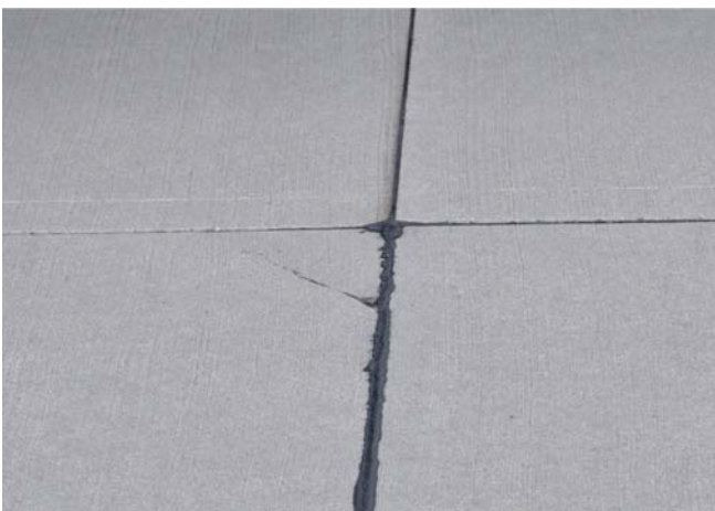
Fot. 9. Uszkodzenie strukturalne – spękania naroży i deformacja szczelin. Autostrada A4 [4]
