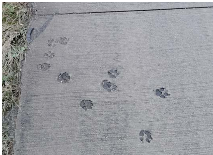
Fot. 14. Uszkodzenie związane z błędami technologicznymi – przykład śladów po zbyt wczesnym wejściu zwierząt na niezwiązaną warstwę nawierzchni. Autostrada A4 [8]
