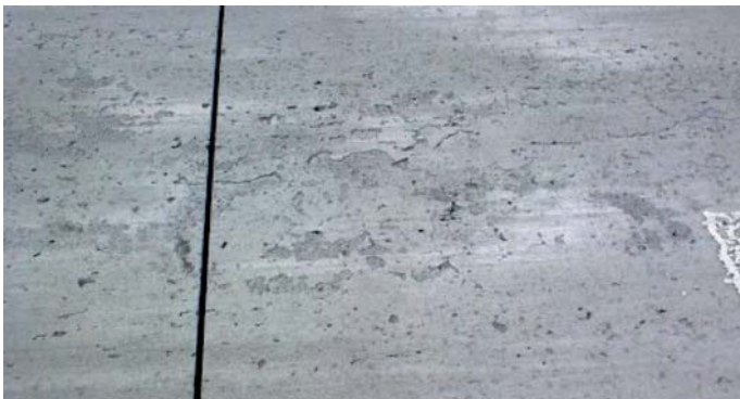
Fot. 4. Uszkodzenie powierzchniowe – złuszczenia powstałe w wyniku „odklejenia” powierzchniowej warstwy mleczka cementowego. Droga krajowa nr 18 [4]
