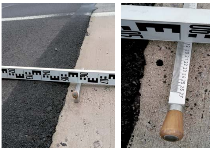
Fot. 21–22. Uszkodzenie i deformacje na styku różnych nawierzchni. Autostrada A4 [8]
