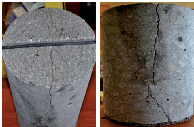
Fot. 16–17. Uszkodzenie związane z błędami technologicznymi – niewłaściwa praca dybli na skutek zablokowania szczeliny. Droga ekspresowa S8 [8]
