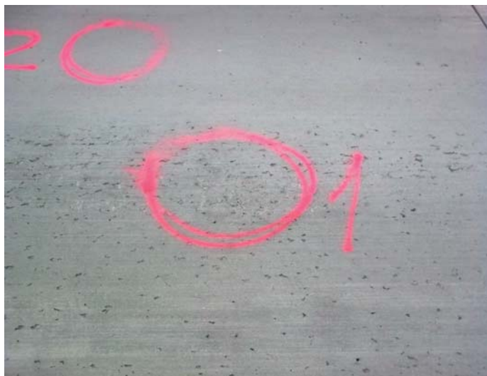
Fot. 13. Uszkodzenie związane z błędami technologicznymi – ślady wleczenia kruszywa po odwróceniu kierunku przejścia podłużnych zabiegów uszorstniających. Droga krajowa nr 18 [8]
