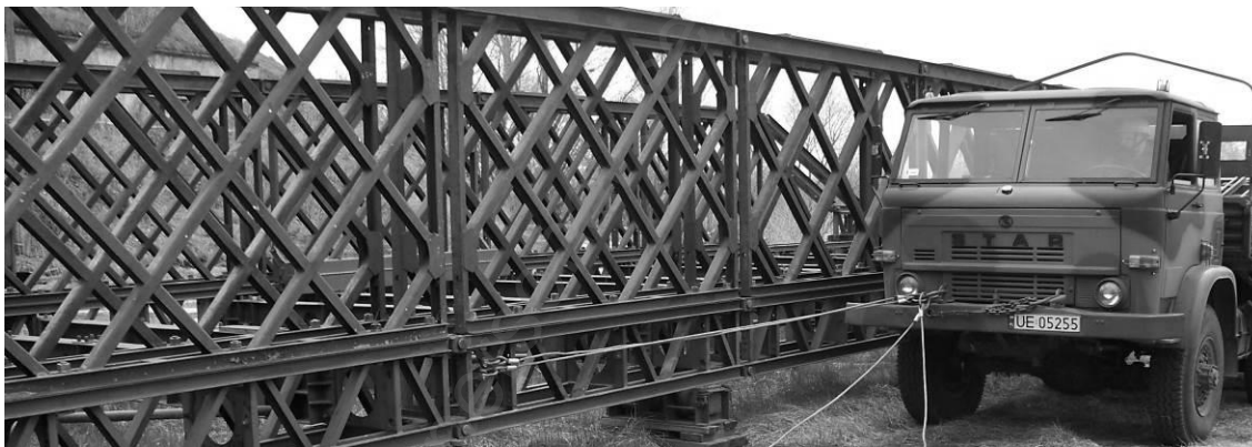
Rys. 13. Nasuwanie konstrukcji przęsłowej DMS-65 liną zamocowaną z boku mostu do jednego pojazdu
