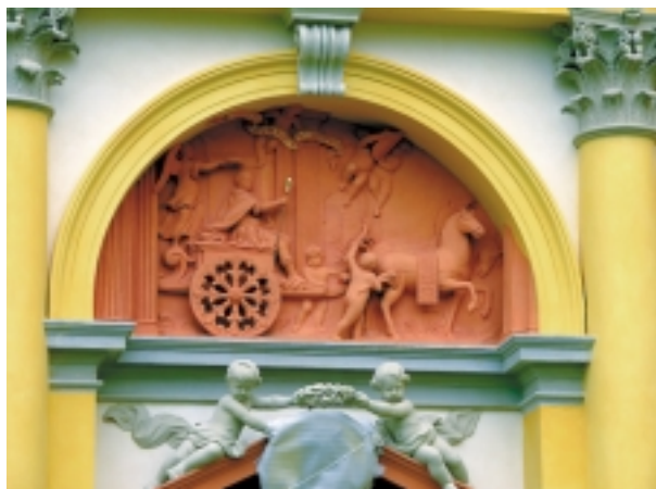
Płaskorzeźba w archiwolcie na elewacji frontowej galerii południowej – Jan III Sobieski na rydwanie triumfalnym po konserwacji. Fot. W. Markiewicz
