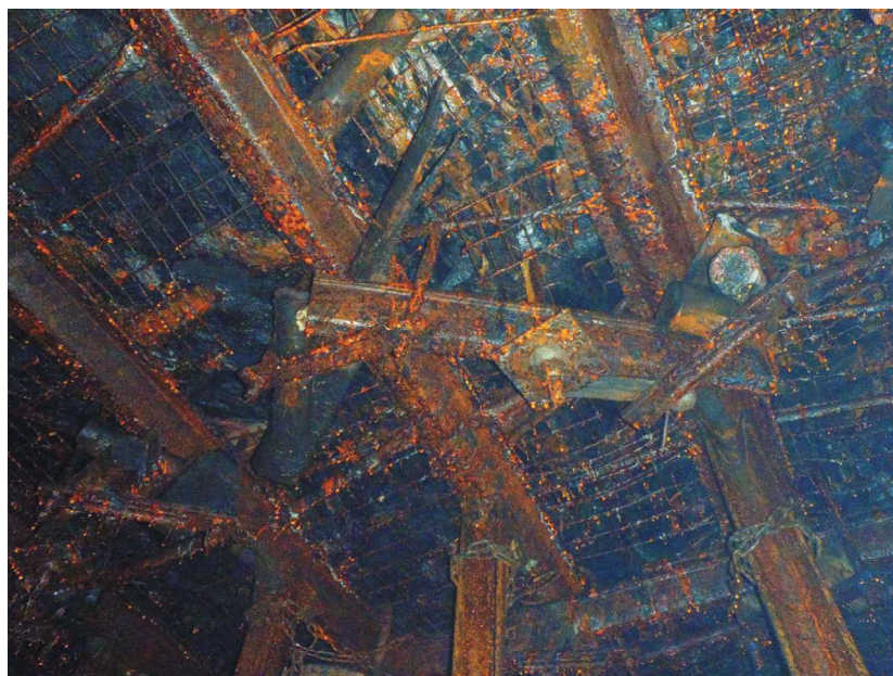
Rys. 2. Zastosowanie kotew AR32N w rozcince ściany 102 w pokładzie 209 Fig. 2. Application of AR32N self-drilling rock bolts in installation cut-trough 102 in coal seam 209
