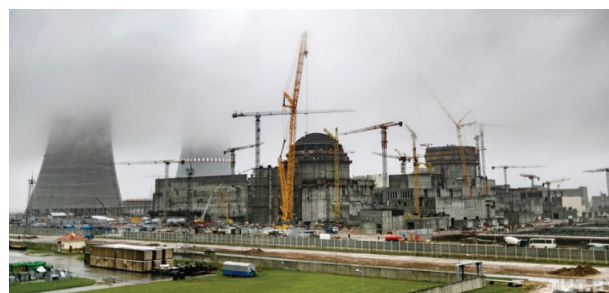
Fot. 2. Białoruska Elektrownia Jądrowa podczas budowy (fot. ze strony BelarusFeed, TUT BY)
