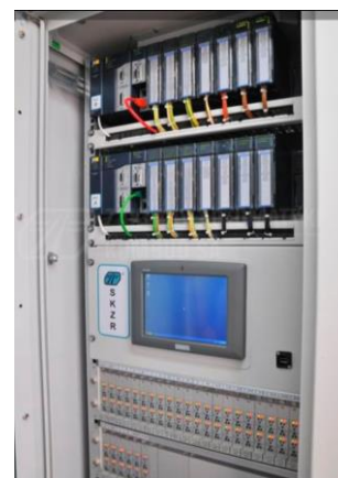
Rys. 2 Widok stojaka z aparaturą systemu SKZR wykonanego w technologii komputerowej
