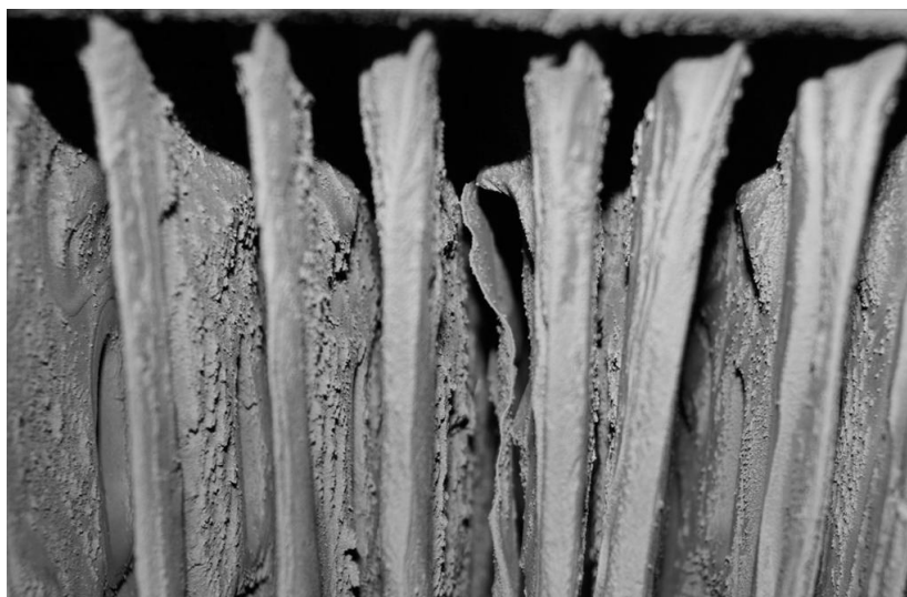
Rys. 2 Rekuperator zanieczyszczony osadami lakierniczymi Fig. 2 Recuperator fins contaminated with overspray sediments
