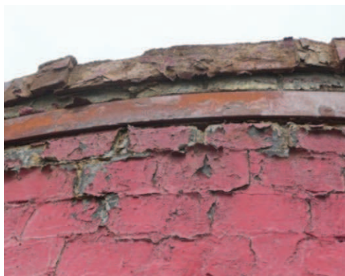
Rys. 1. Ubytki zaprawy w kominie murowanym
