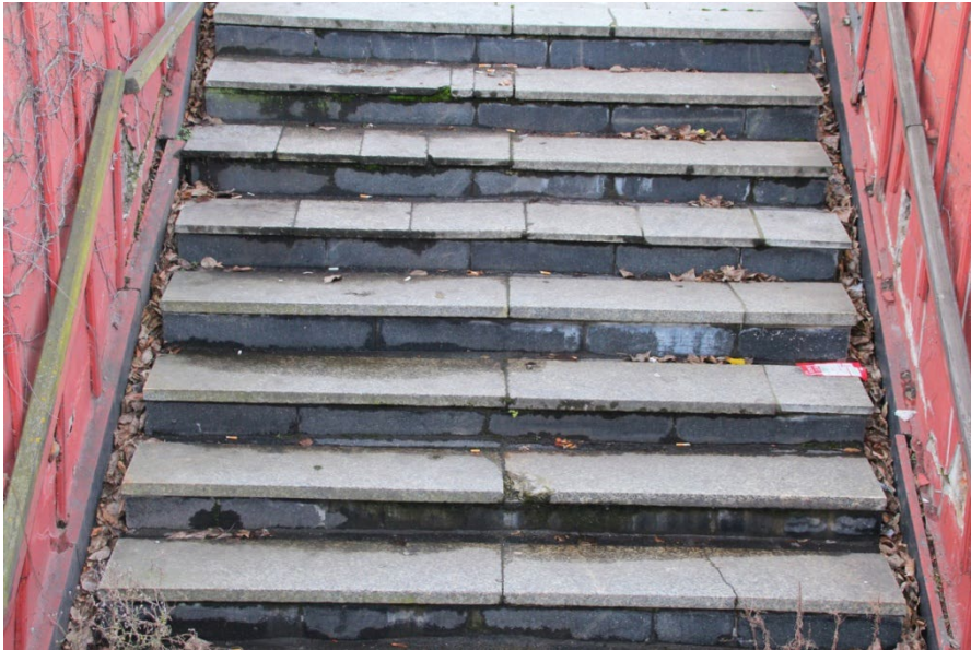
Ryc. 4. Efekt nieodpowiednio zaprojektowanych i wykonanych schodów z granitu (fot. archiwum autorów)
