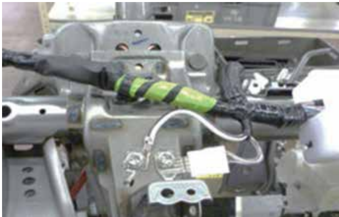
Fot. 3. Użycie udoskonalonej, widocznej taśmy łączącej wiązkę przewodów instalacji elektrycznej [3]
