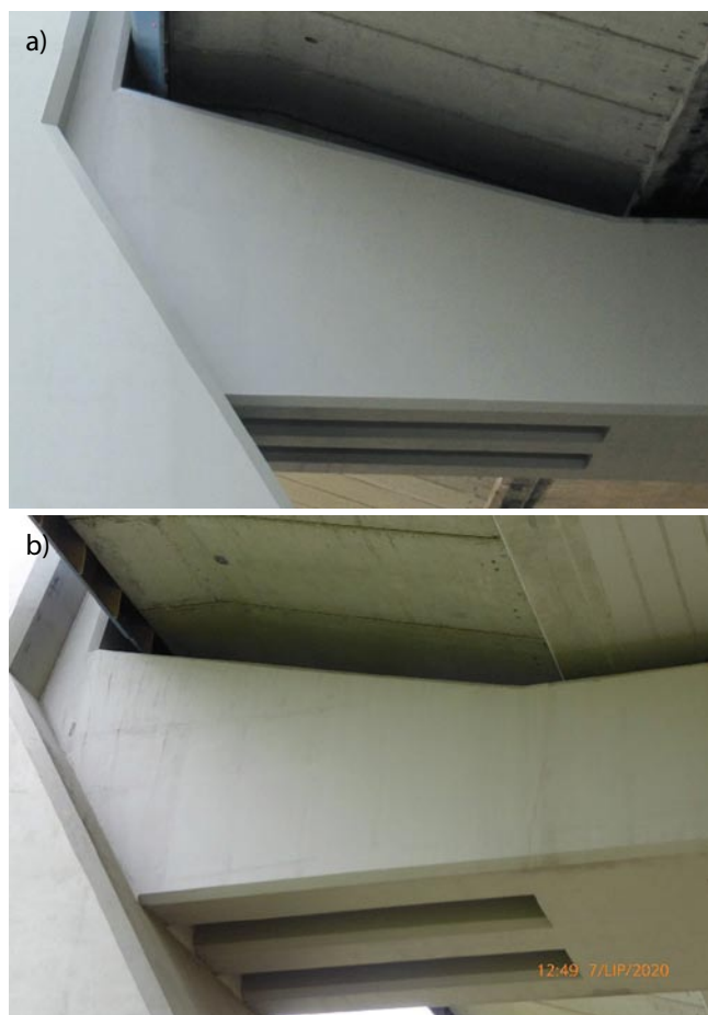
Rys. 1. Fragment pylonu Mostu Rędzińskiego w obrębie połączenia z dolnym rygłem; stan z 11.08.2011 (a) i 07.07.2020 (b)
