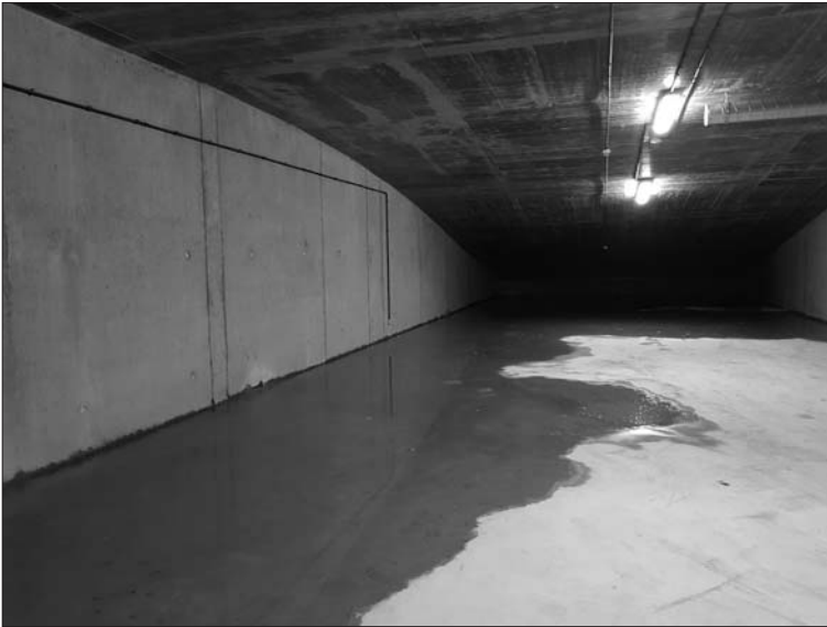
Ryc. 2. Pęknięta płyta fundamentowa z zaznaczonym wypływem wody. Fot. R. Kaczmarczyk
