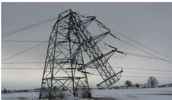
Rys. 3. Uszkodzone słupy wysokiego napięcia Szczecin, 2008 [3]
