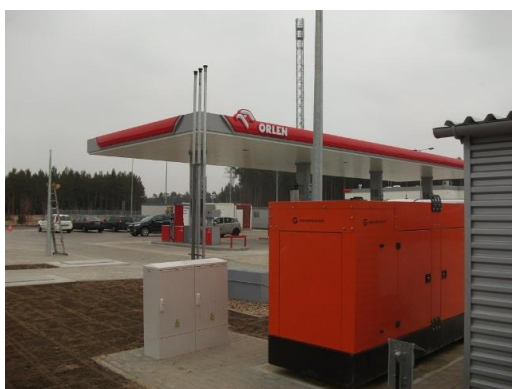
Rys. 6. Agregat prądowłczy na stacji PKN ORLEN przy autostradzie A2 [5]
