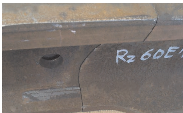
Rys. 3. Pęknięcie szyny C dziobu krzyżownicy rozjazdu [fot. autor]
