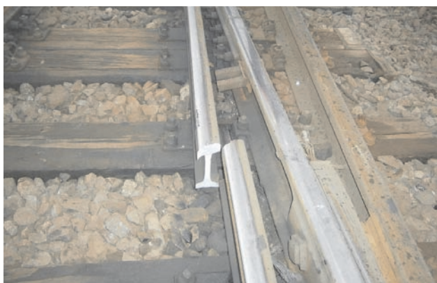
Rys. 2. Pęknięcie szyny B iglicy rozjazdu [fot. autor]
