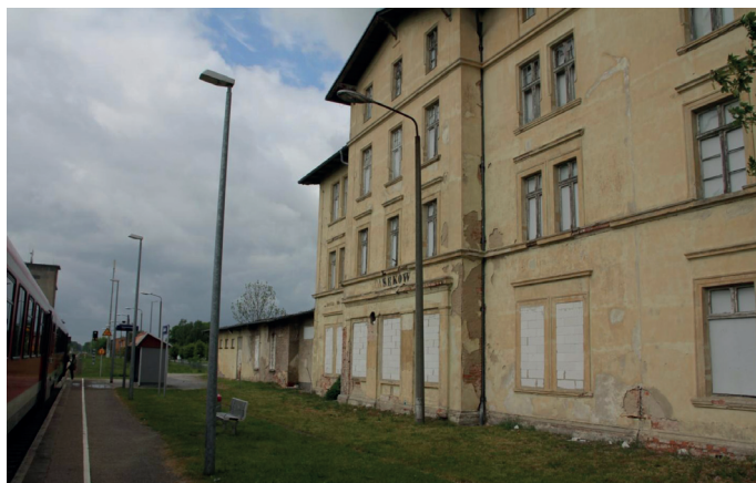
Fot. 1. Zdekapitalizowana infrastruktura dworcowa w Casekow.
