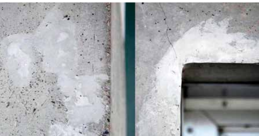
Fot. 6. Przykład naprawy betonu architektonicznego przy użyciu niewłaściwie dobranej zaprawy naprawczej
