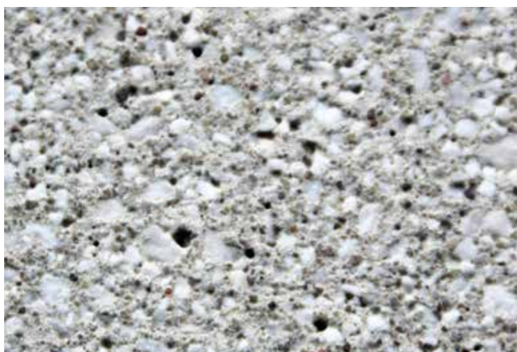
Fot. 10. Uwidocznienie wad podczas piaskowania
