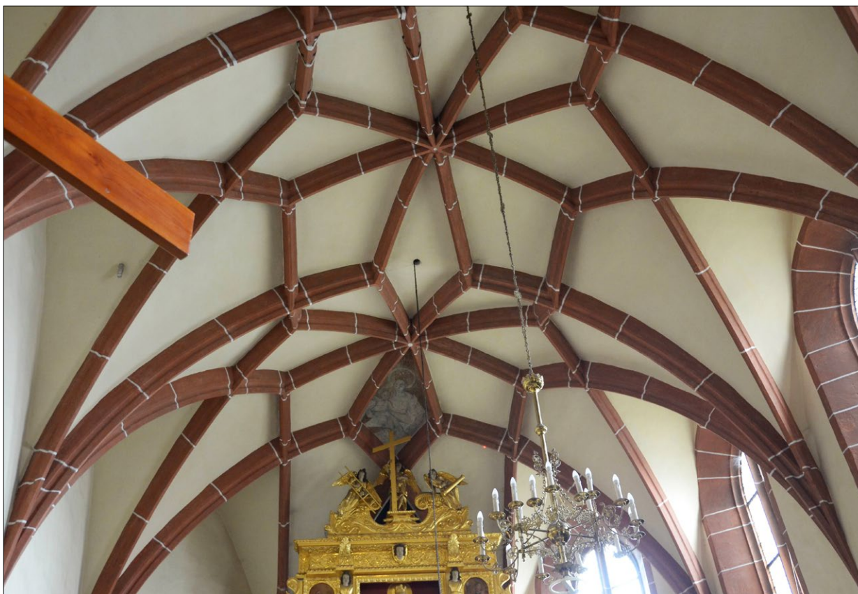
Ryc. 3. Współczesny stan gotyckich sklepień prezbiterium kościoła; fot. autorzy.
