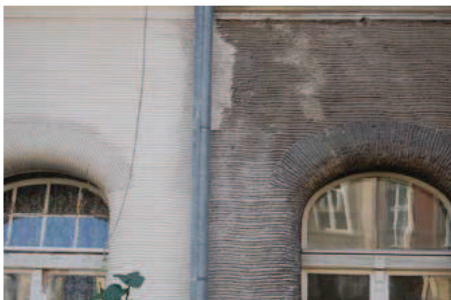
Rys. 11. Fragment elewacji z wyprawą rowkową przed i po konserwacji – nowy tynk rowkowany jest zbyt regularny i różni się tynku oryginalnego, Świdnica ul. Jagiellońska 15–17 (fot. M. Korpała 2008)
