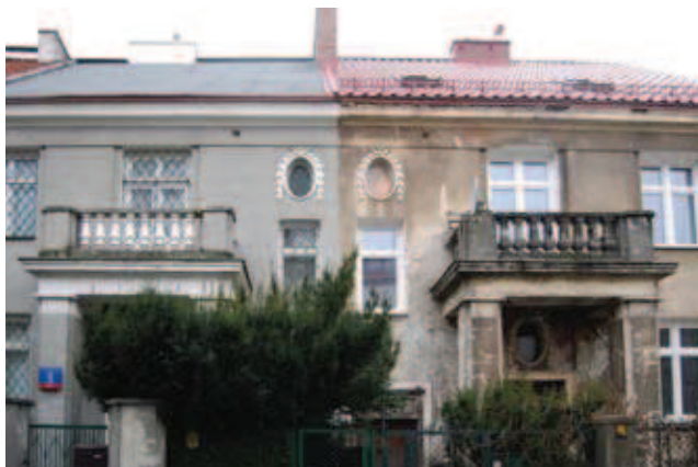
Rys. 10. Elewacja bliźniaczej kamienicy, której tylko połowa została odnowiona (wykonanie nowych tynków szlachetnych i pomalowanie) – pozwala ocenić zakres zmian w stosunku do części nieodnawianej, Warszawa, ul. Prezydencka 3. ok. 1926 (fot. M. Korpała 2017)
