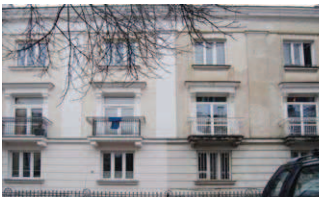
Rys. 12. Elewacja bliźniaczej kamienicy, której tylko połowa została odnowiona (ponowne nowych tynków szlachetnych i pomalowanie) – pozwala ocenić zakres zmian w stosunku do części nieodnawianej. Przykład zachowania spójności kolorystycznej kompozycji elewacji, Warszawa, ul. Mianowskiego 5, ok. 1926 (fot. M. Korpała 2017)
