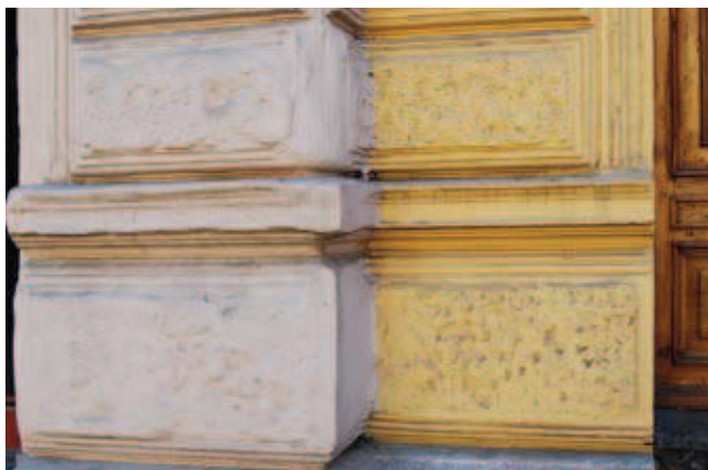
Rys. 2. Przykład niefachowych napraw maskujących farbą uszkodzenia i zniszczenia tynku szlachetnego fragment cokołu z tynkami kamiennymi (fot. M. Korpała 2008)
